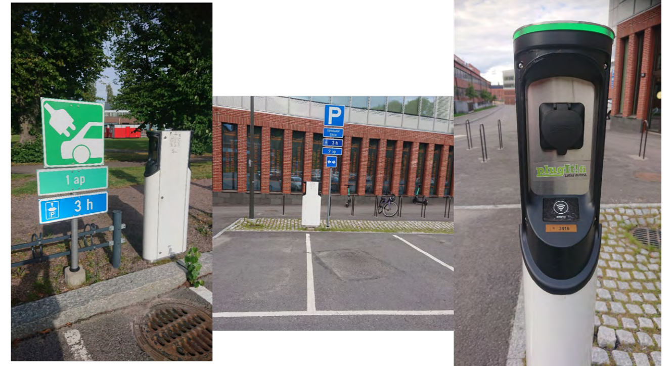
Kuva 36. Esimerkkejä sähköautojen latauspaikoista Espoossa.
